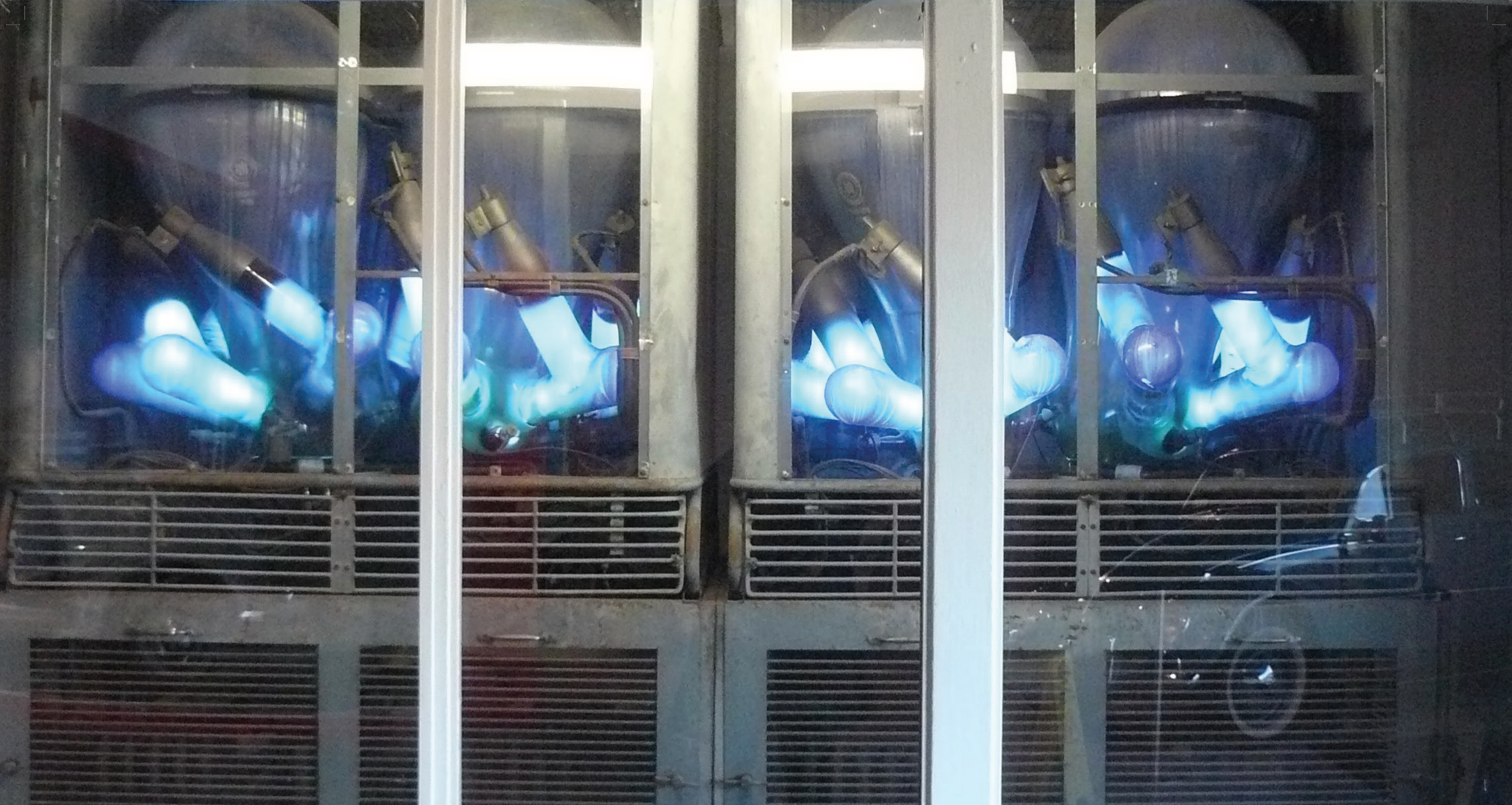
Mercury arc rectifier
